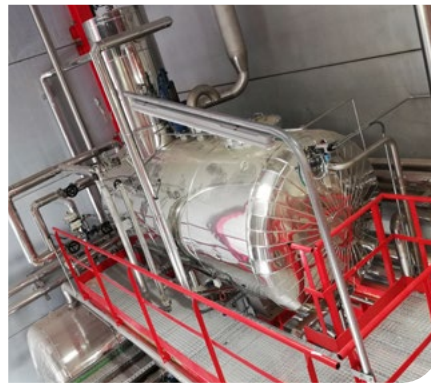
Tanque de desgasificador de agua de alimentación a caldera de vapor.
