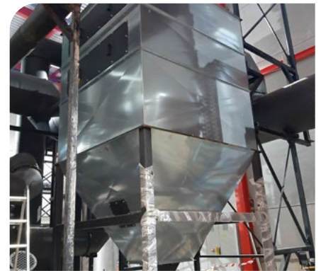
Multiclón con sistema de recogida de cenizas.
