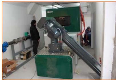
SALA DE CALDERAS (SINFÍN)
